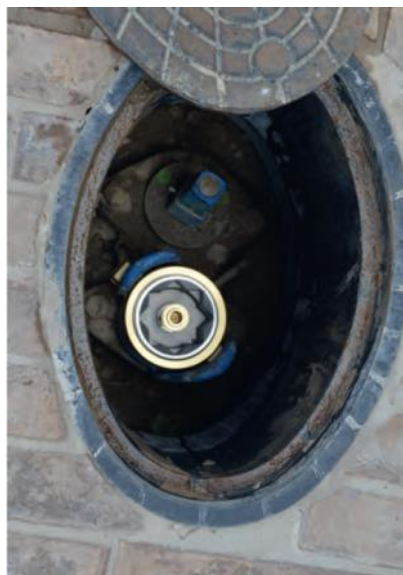
Hydrantenverschluss mit Schnellverschluss NW 7.2 am Hydranten DN 80
