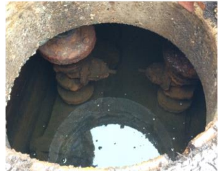
Havariertes Schacht mit zwei Be- und Entlüftungsventilen
