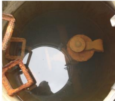
Überflutetes Be- und Entlüftungsventil
